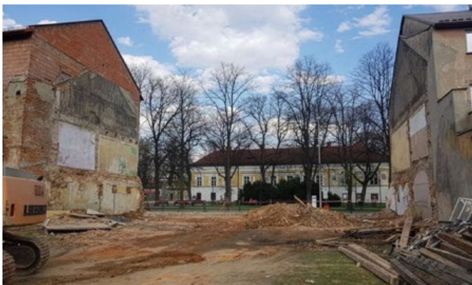
Pożar „romskiej” kamienicy przy ul. Rynek 3 w Andrychowie w dniu 7 stycznia 2014 r., bezpośrednio po relokacji z niej Romów i widok po jej wyburzeniu. Fot. www.mamnews.pl
